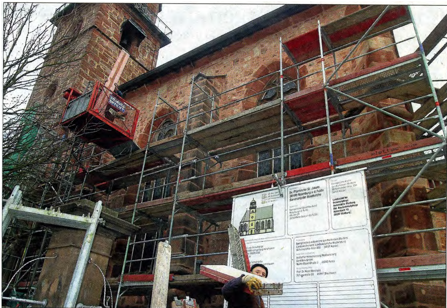
Sanierung beendet: Die Fassade des Jakobi-Kirchenschiffs zur Breitenstraße hin ist fertig. Unser Foto entstand beim Abbau des Gerüsts. Es ist inzwischen verschwunden. Am unteren Teil des Turmes bleibt es stehen - der nächste Bauabschnitt.
